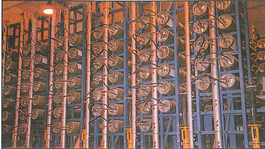
● جانب من وحدات التحلية بواسطة التناضح العكسي بمحطة مياه صلبوخ
