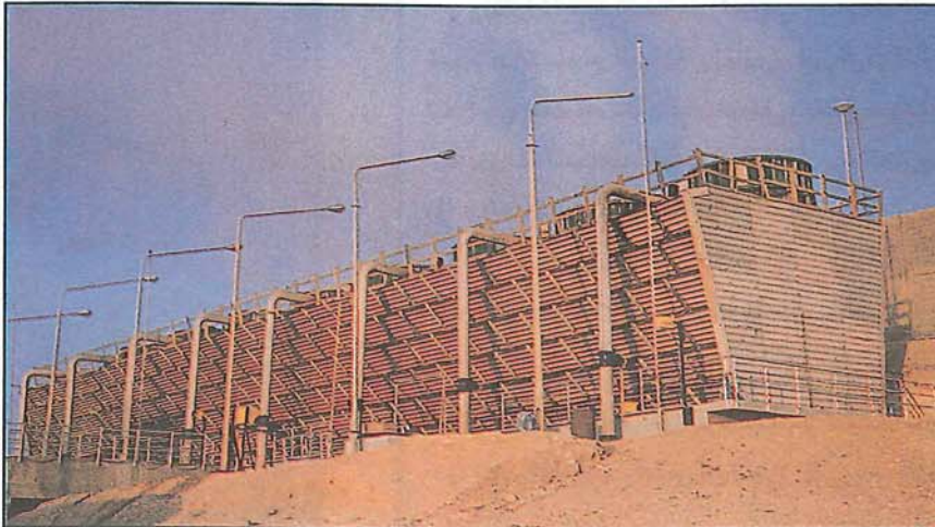
● جانب من وحدات التبريد بمحطة مياه صلبوخ
